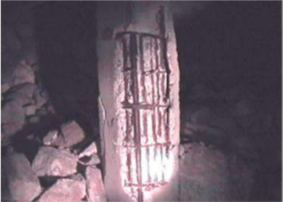
YANAL DEFORMASYON GÖSTERMİŞ KOLON
