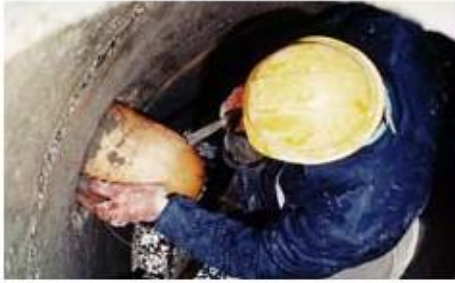
2. Hasar görmüş boruların içi ve derzleri tıkanır.
